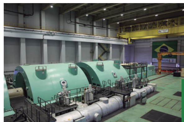
Instalações da Usina de Angra 2 na Central Nuclear Almirante Álvaro Alberto/ Tomaz Silva, Agência Brasil
