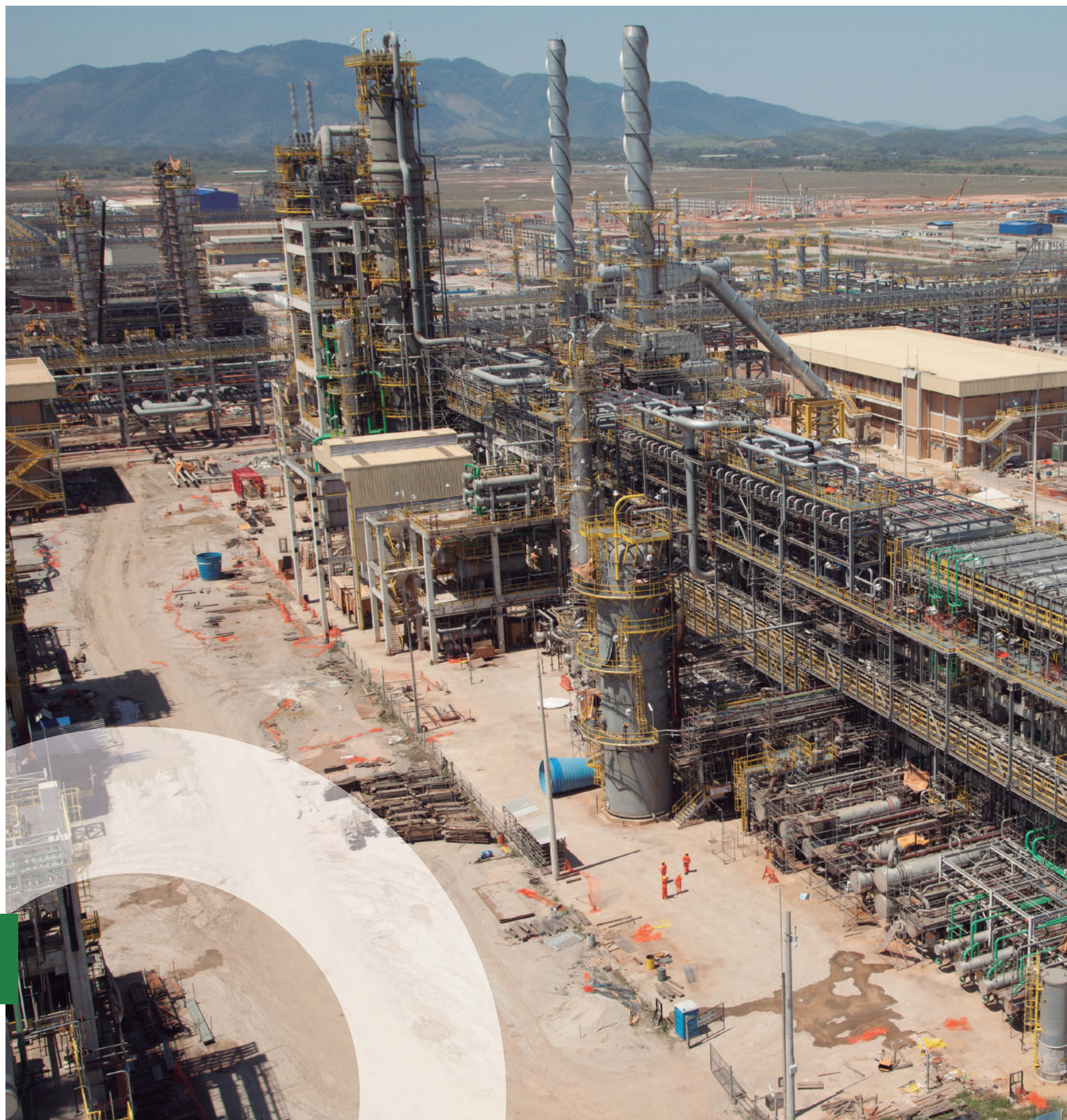
Processamento de Gás Natural/Fred Bailoni, Banco de Imagens Petrobras
