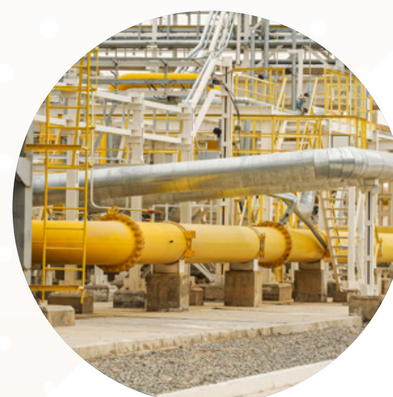
Processamento e Transporte de Gás
