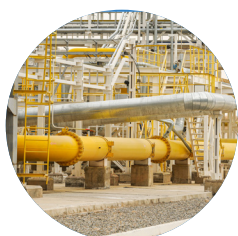
Processamento e Transporte de Gás
